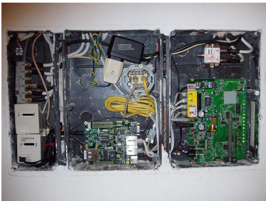
Figura 7: Caja de telecomunicaciones a la entrada de la vivienda.
